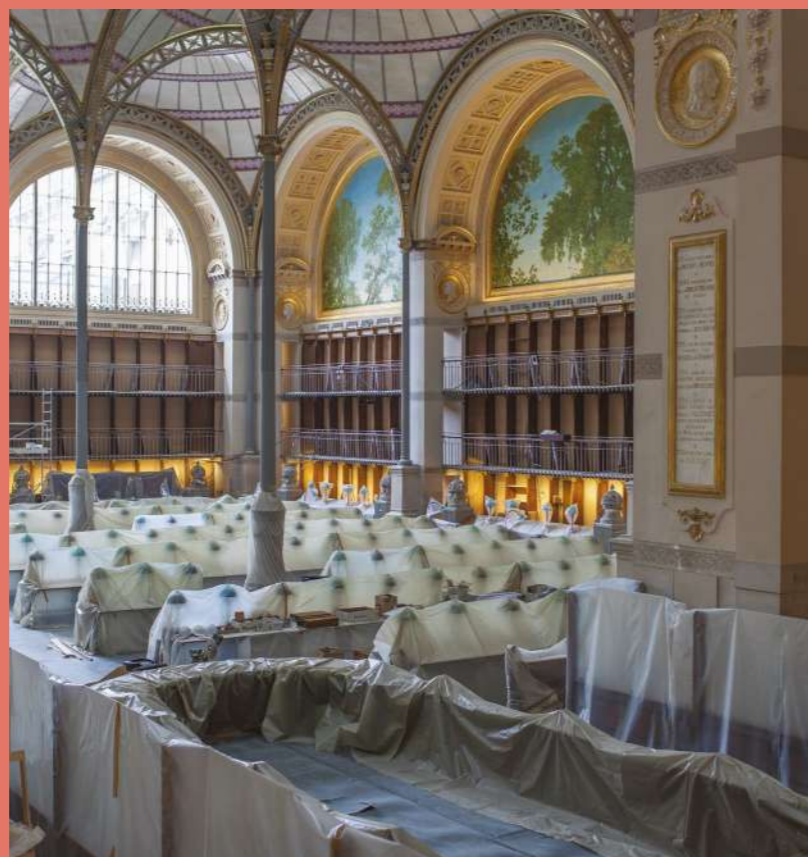
Vue d'ensemble de la salle Labrouste pendant son réaménagement. © Jérôme Delatour, INHA, 2015.
